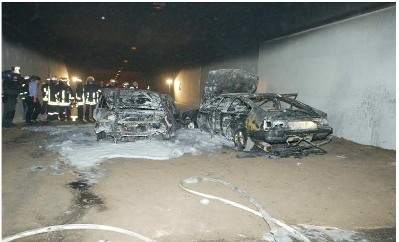
Bild 50: Die beiden Autowracks nach dem Löschen mit Mittelschaum, von Westen gesehen. Die Deckenleuchten waren vom Ruß geschwärzt und die Leuchtenkabel, die Antenne, das Brandsensorkabel und das ECS-Gerät an der Decke waren beschädigt und zu erneuern.
