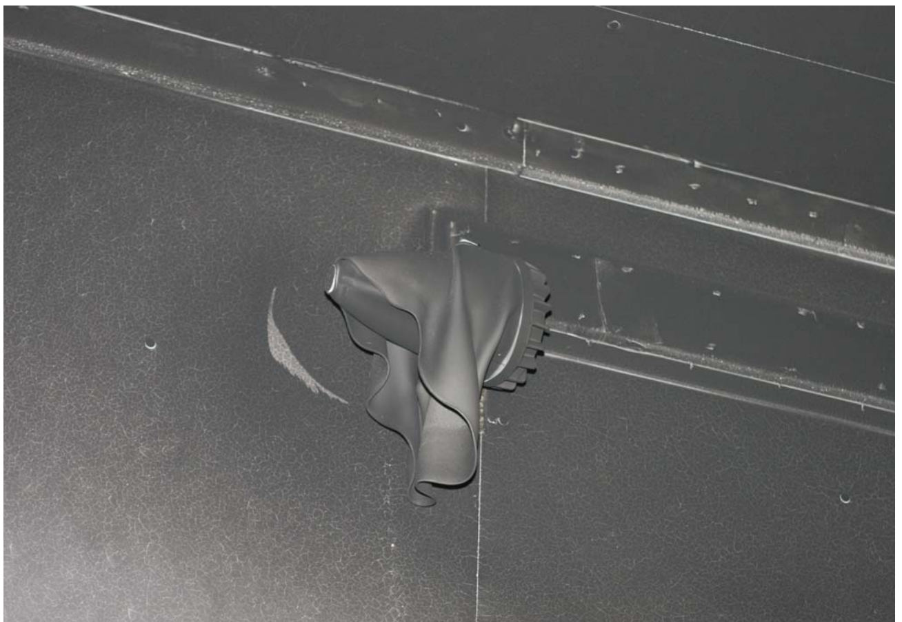
Bild 53: Ein geschmolzenes Lautsprechergehäuse im Bereich der Rauchgasschicht nach dem Brand.
