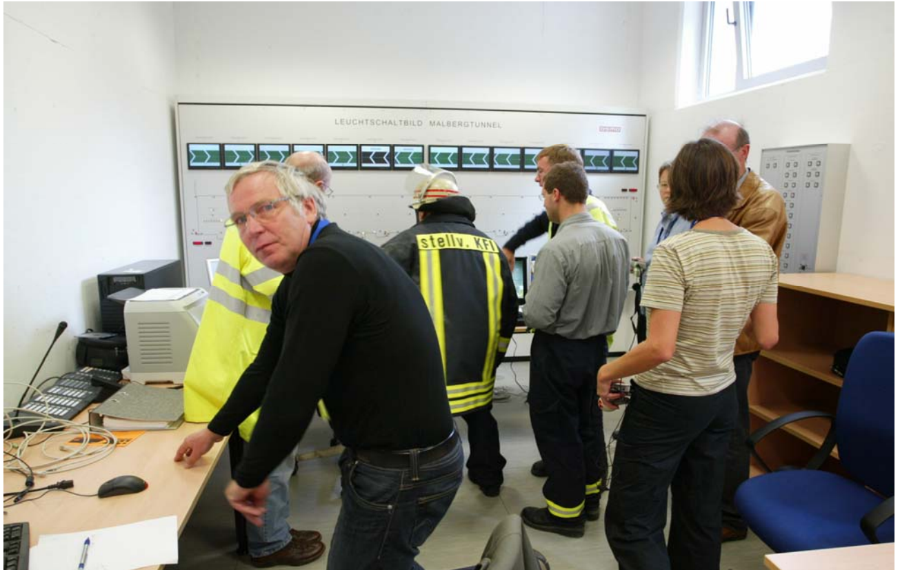
Bild 47: Bedienplatz mit Leuchtschaltbild und 14 Farbdisplays (TFT) zur dynamischen Visualisierung der Rauchströmung (Richtung und Geschwindigkeit) und der Temperatur (als Hintergrundfarbe), mit dynamischen Betriebs- und Störanzeigen für Ventilatoren, Klappen, Drehzahlen, Blasrichtungen, CO-Gaskonzentrationen, Lufttrübungsfaktoren, Lufttemperaturen und Strömungsgeschwindigkeiten.
