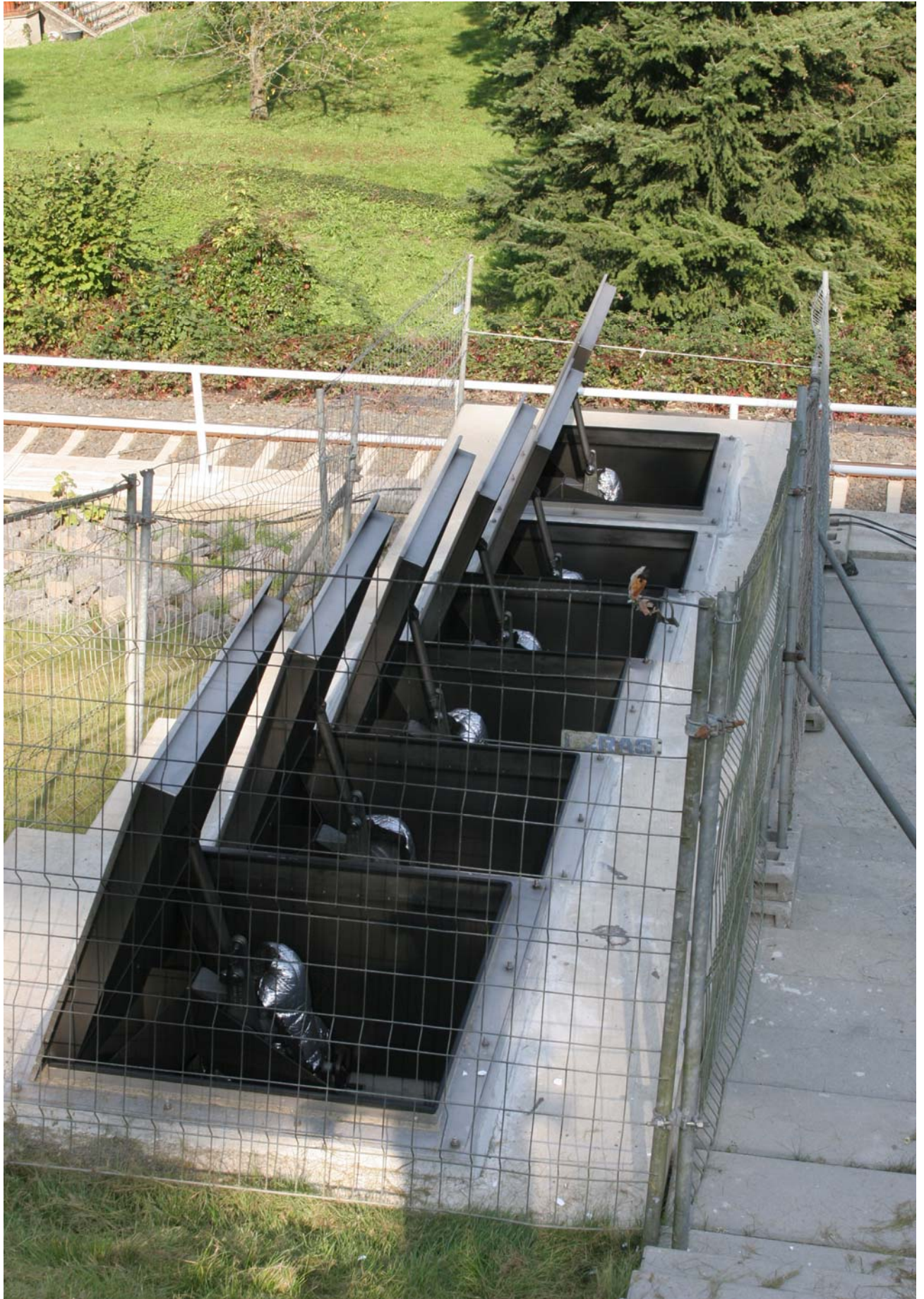
Bild 51: Die Klappen der Entrauchungsstationen (hier die Station Nr. 06) mit Stellantrieben und Hitzeschutzummantelungen waren nach dem Brand völlig unbeschädigt und noch voll funktionsfähig.
