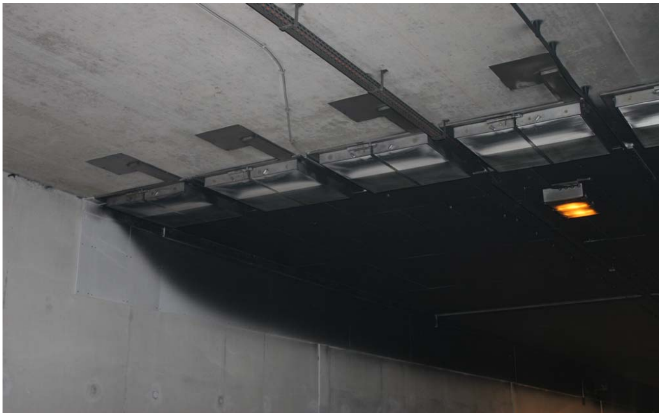
Bild 57: Die geschwärzte Tunneldecke und Leuchte nach dem Brand sowie der schwarze, 1 m hohe Wandstreifen an der Tunnelsüdwand bei der Entrauchungsstation Nr. 05 zeugen von der exakten Rauchführung während des Brandversuches (gleiches war an der Entrauchungsstation Nr. 06 zu sehen).
