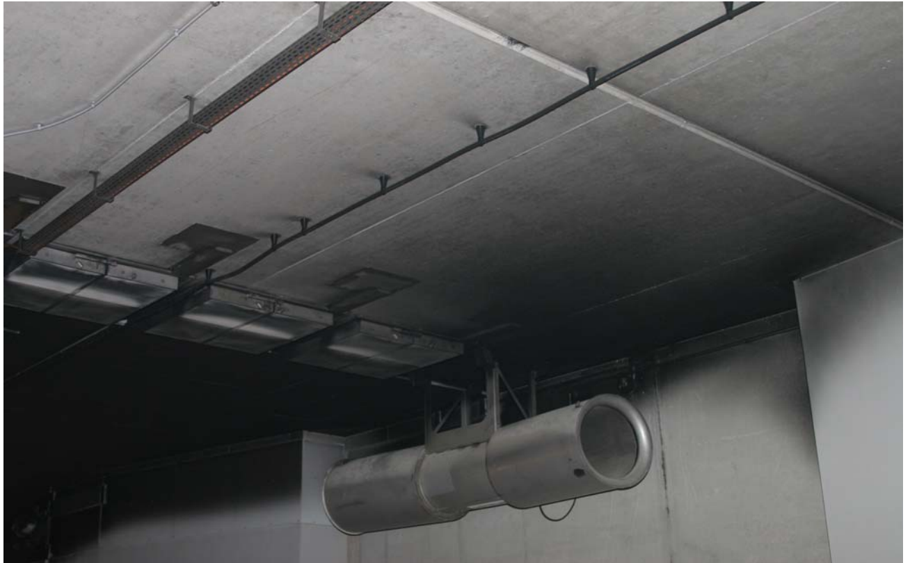
Bild 56: Nach dem Brand: Die geschwärzte Tunneldecke und ein schwarzer, 1 m hoher Wandstreifen an der Tunnelnordwand bis zur Entrauchungsstation Nr. 05, wo ein Teilstrom des Rauchgases in der Strahlventilatornische an der Decke zirkulierte (die westlichen Strahlventilatoren waren während der Entrauchung im Umkehrbetrieb, ohne jedoch mit den Rauchgasen in Kontakt zu kommen).
