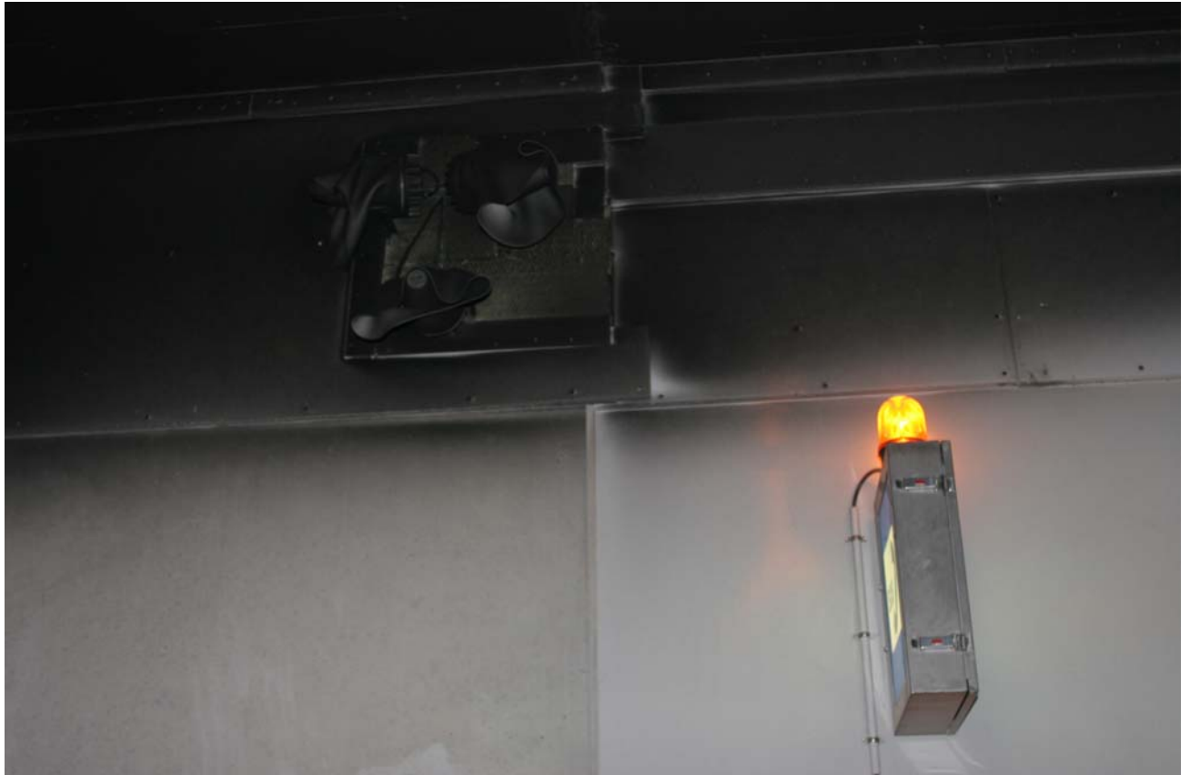
Bild 54: Die SOS-Notrufleuchte mit Rundumblitzleuchte, die an der Tunnelwand, unterhalb der Rauchschichtströmung, montiert waren, blieben unbeschädigt und waren nicht geschwärzt und sauber.
